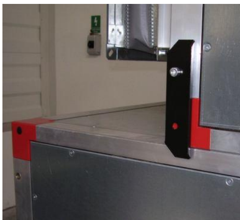
Obr.6 ÚPRAVA PRO VENKOVNÍ PŘÍKONNÍ - DODATEČNÉ ZAJIŠTĚNÍ KOMOR
